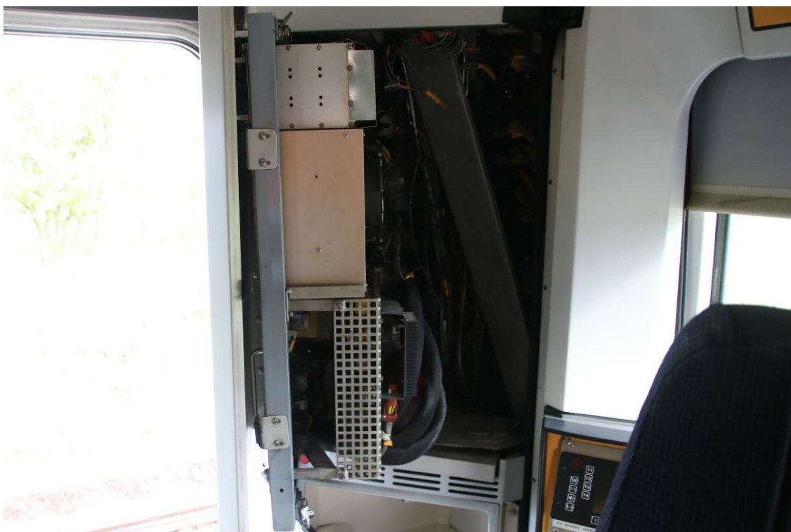
Elektronikskab i førerrummet var sprunget op, hylder var faldet ned, og der var skader på elektriske komponenter og kabler. (Foto DSB).
