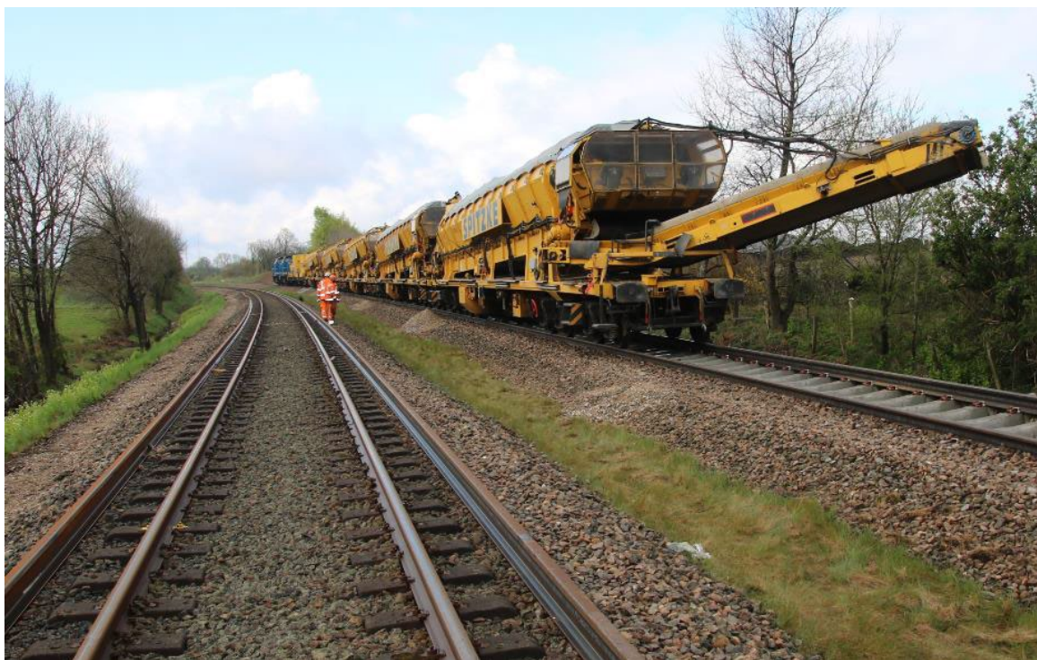
Uheldsstedet set i køreretning Skørping - Hobro. Udlæggerbåndet som er 5 meter langt og hænger i en wire ud fra vognen. Efter kollision blev det slynget ca. 135 garder bag rundt om vognen. Højdeforskel mellem højre og venstre skinnestreng er 90 mm i begge spor. Niveauforskellen mellem de to spor er 317 mm. (Foto DSB).
