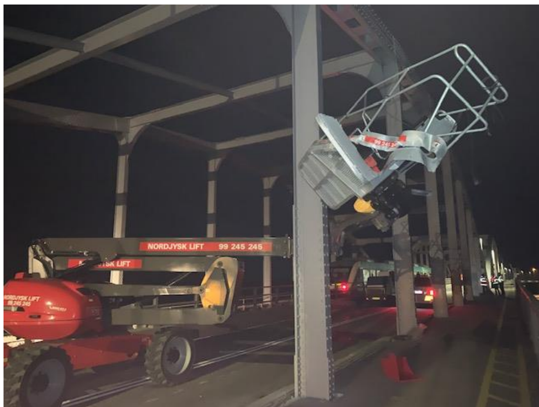
Foto 3 Lift og kurv efter påkørslen - svinget over i modsat side af broen (væk fra jernbanesporet).
